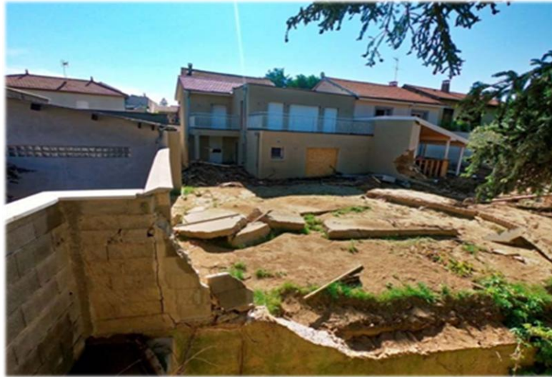
Débordement du Vernatel ayant entraîné une rupture des murs en rive droite provoquant une inondation par vague de submersion d'un bâti riverain en 2018 à Chaponnay (Source : HTV)
