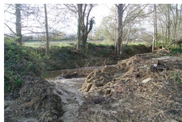
Rupture de merlon à Marennes lors de la crue de 2014 (Source : PAPI d'intention)
