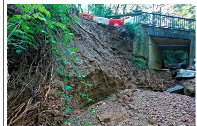
Erosion du fond du lit et des berges sur la Combe Saint-Jean et fissuration de la structure de l'ouvrage en 2018 (Source : HTV)
