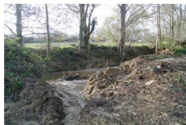
Rupture de merlon à Marennnes lors de la crue de 2014 (Source : PAPI d'intention)
